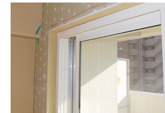
↑内窓 (樹脂サッシ)
